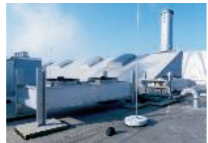
Izoliuota apsaugos nuo žaibo sistema ant antstatų
