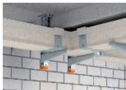
Montavimui paruoštos standartinės tvirtinimo detalės
