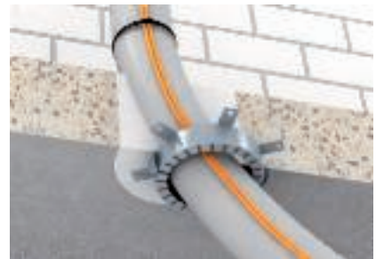
Pneumatinių kabelių įranga su 2 šalutiniais kabeliais
