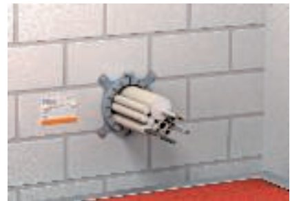
Paženklinta instaliacijos vamzdžių grupės izoliacija
