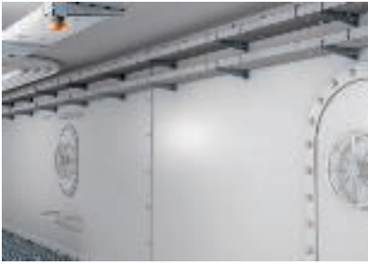
Izoliacinių apvijų naudojimas agresyvioje aplinkoje, pvz., jūroje
