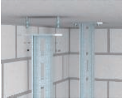
Naudojimas prie lubų Standartinis lubinių profilių montavimas prie betono lubų, naudojant sraiginius ankerius.
