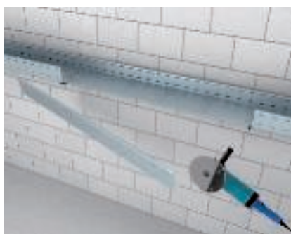
T formos atšakos realizavimas, naudojant kampinį jungiamąjį elementą Šoninių sienelių ištraukimas iš ištiesinių ilgų kabelių lovelių.
