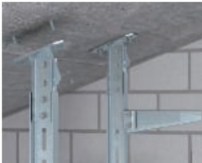
Padas, reguliuojamas KI 8 VQP tipo reguliuojamos dengiamosios plokštės montavimas prie pasvirusių betono lubų, naudojant sraiginius inkarus.
